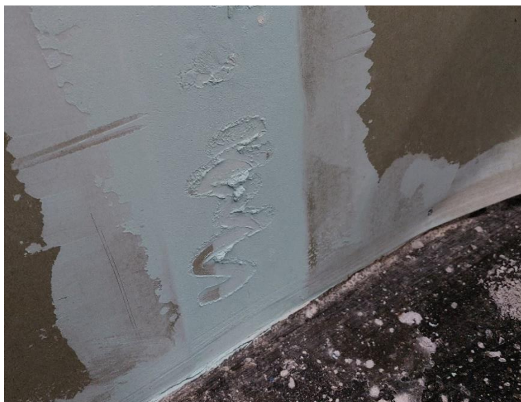
Abb. 11: Aufgeweichte Spachtelmasse bei Plattenstössen nach Wassereinstau
