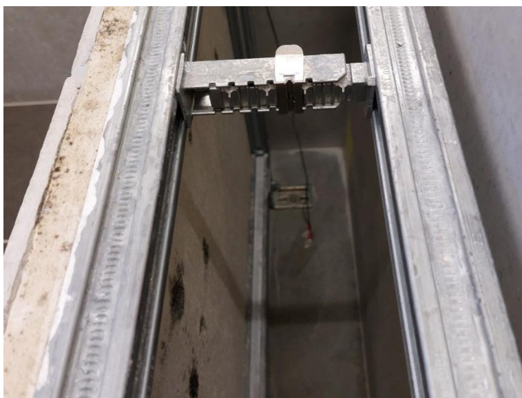
Abb. 10: Vereinzelter Schimmelpilzbefall auf Aquapanelplatten bei Vorwandinstallation GIS
