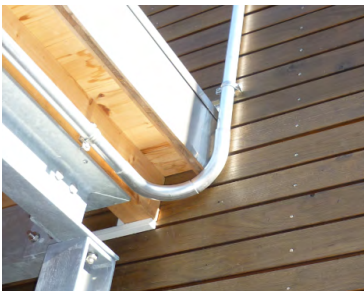
PV-Gleichstromleitung auf brennbarer Holzfassade in nichtbrennbarem Schutzrohr RF1
