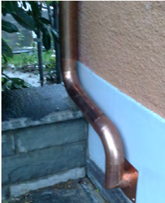
PV-Gleichstromleitungen in Schutzrohr RF2 und in Kupfer-Fallrohr RF1 an Aussenfassade
