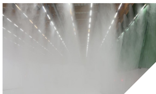
Löschanlage ca. 30 Sekunden nach Auslösung, Quelle: NSV
