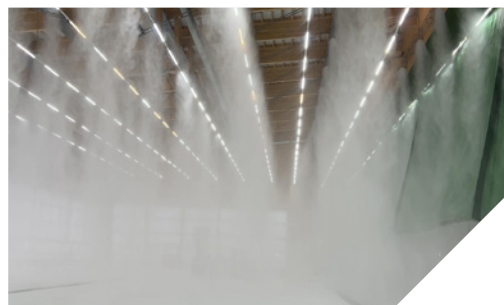
Löschanlage ca. 20 Sekunden nach Auslösung, Quelle: NSV
