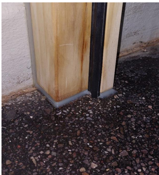
Abb. 10: Verfärbter, jedoch intakter Türrahmen aus Accoya nach Wassereinstau.
