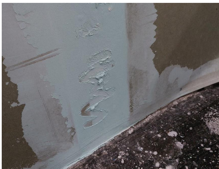
Abb. 9 Aufgeweichte Spachtelmasse bei Plattenstössen nach Wassereinstau
