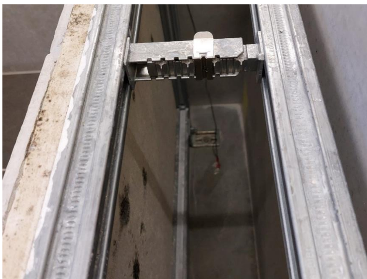
Abb. 8: Vereinzelter Schimmelpilzbefall auf Aquapanelplatten bei Vorwandinstallation GIS
