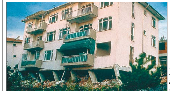
«Soft-storey»: Unterbruch der aussteifenden Wände im Erdgeschoss. Diese Schwachstelle kommt in der Schweiz oft vor.
